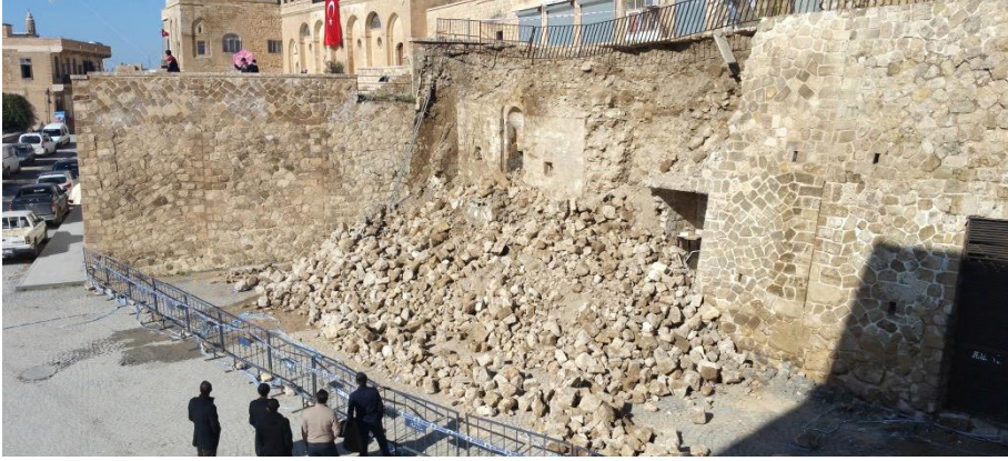
Şekil 1: 2019’da yıkılan istinat duvarı ve altından çıkan kalıntılar (Murat Çağlayan Arşivi).
