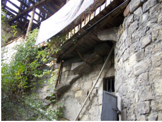
Resim 21. Güney Cephede Yok Olan Merdivenden Kalan Taş Basamak İzi
