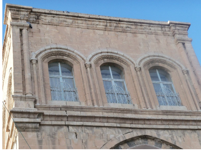
Şekil 2. 9 Çift cidarlı yığma yapı binada duvar çatlaması (Mungan, 2020)
