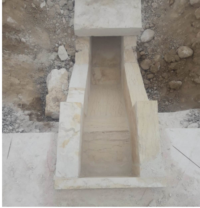
Şekil 3. 30 Galerî kanalı havalandırma çıkışı
