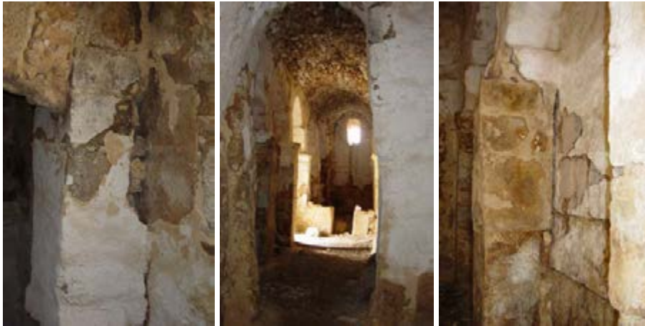
Şekil 10. Nartekste strüktürel bozulmalar- kireç sıva dökülmesi
