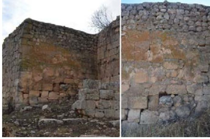
Şekil 17. Şapelin kuzey dış duvarında bulunan kapatılmış boşluk
