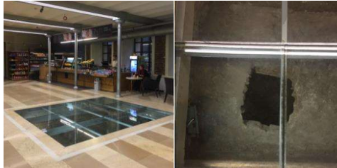
Şekil 1. Kafeterya bölümünün zemininde kullanılan cam döşeme (Özbalta, 2017)
