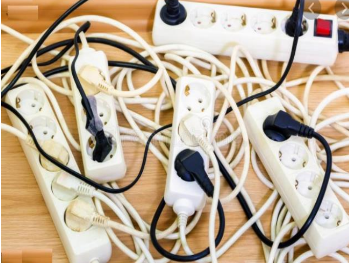
Şekil 9. Aşırı Yüklü Standartla Aykırı Kablo Bağlantıları
